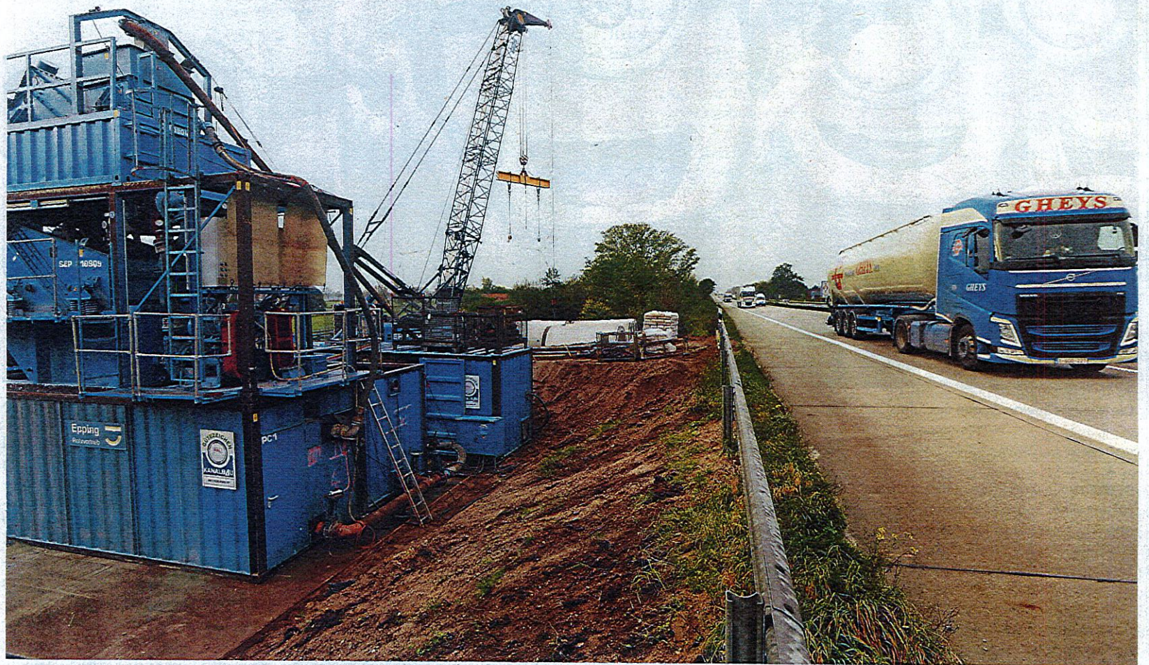
Von Süden her wird der Tunnel unter der Autobahn 40 vorangetrieben. In den blauen Turm wird Wasser und Erdreich von der Bohrstelle gepumpt. RP-FOTOS (5): EVERS
